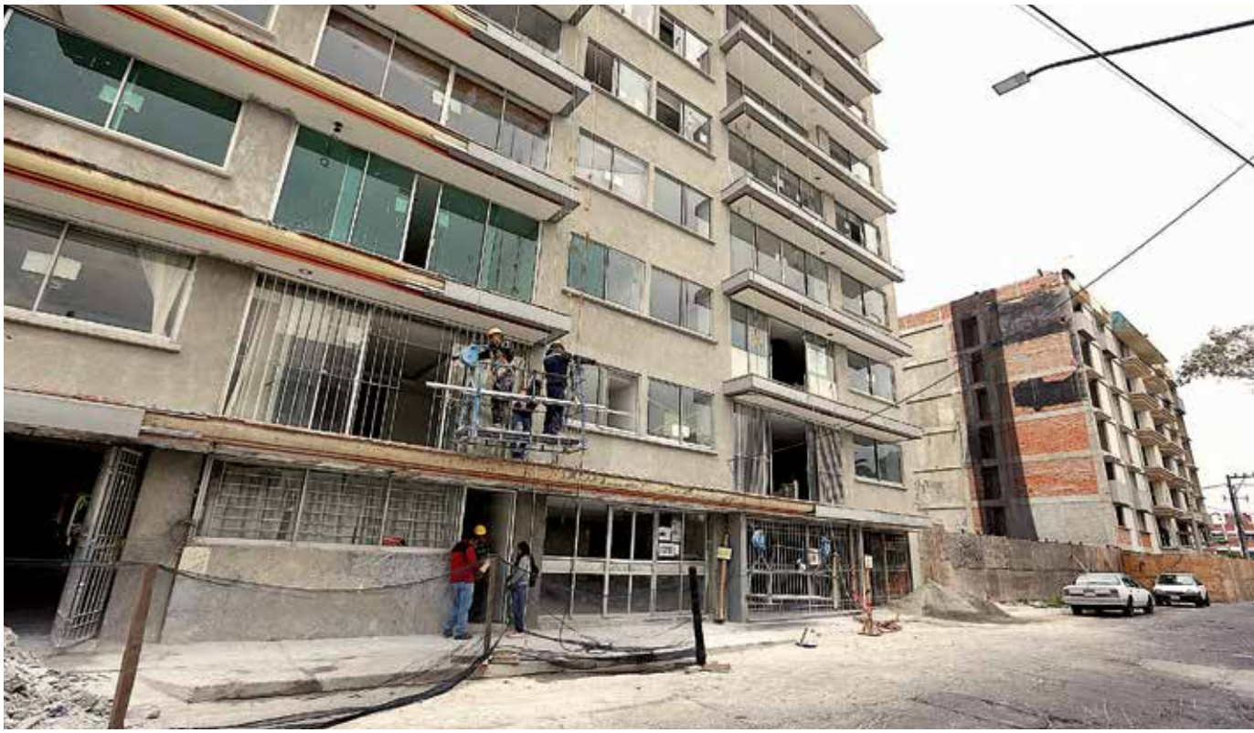
Edificios habitacionales de la alcaldía Gustavo A. Madero sufrieron daños severos durante el terremoto de 2017. México ocupa el octavo lugar a nivel mundial en exposición a fenómenos perturbadores naturales y humanos, de acuerdo con el Índice de Gestión de Riesgos 2019.
